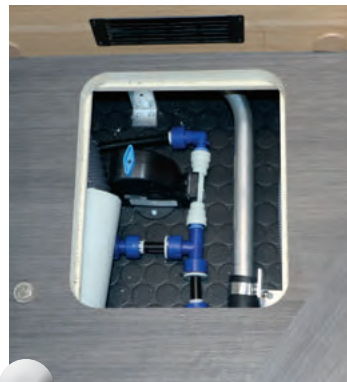
- Zugang zum Frostwächterventil.
