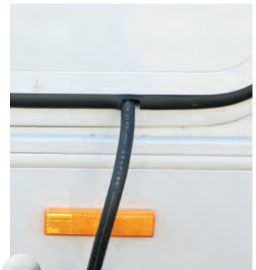
- Bessere Kabelführung gewünscht.
